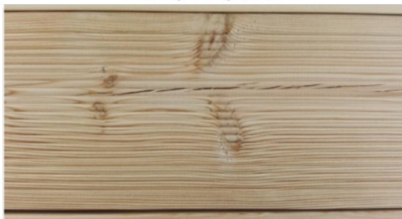
Fot. 3 - pęknięcie włosowate
