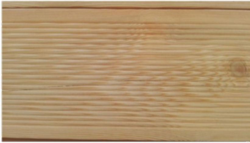
Fot. 16 - pęknięcia typu „włos”
